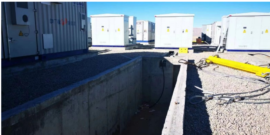
图 4.4-1 储能区电池舱底部基础坑
