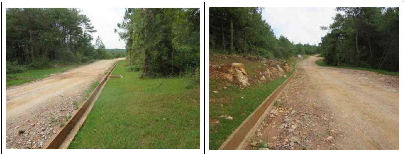
图 5.3-1 国内南方地区其它风电场道路永久硬质截排水沟和沉淀池实景图
