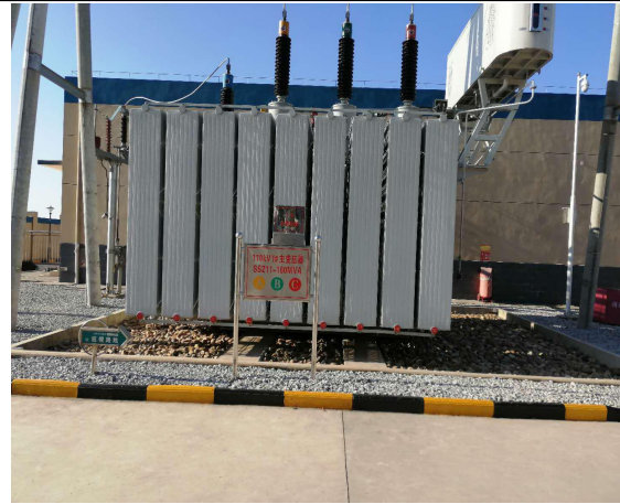
图 7.6 油污水收集设施
