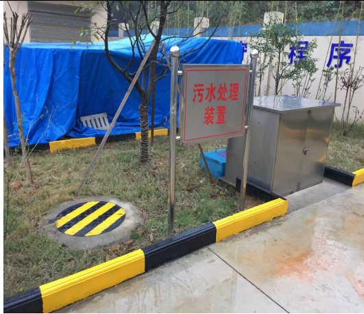
图 7.5 升压站一体化污水处理设施
