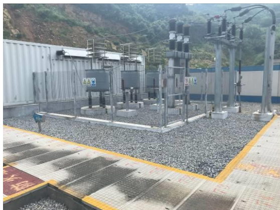
升压站配电装置区照片
