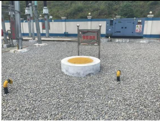
110kV 升压站内事故油池
