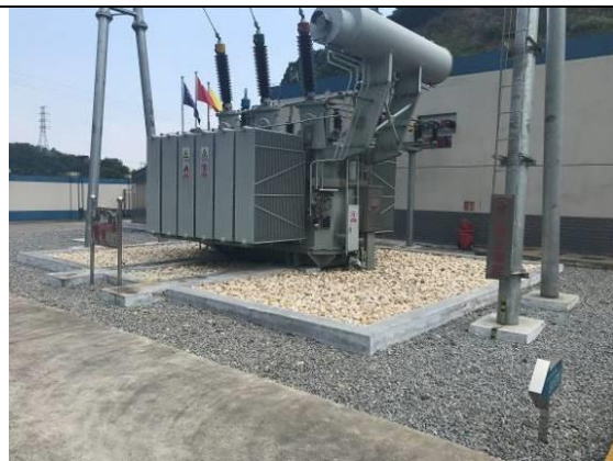
升压站主变下方鹅卵石层
