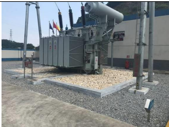
110kV 升压站主变照片
