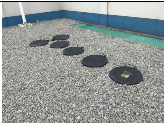
110kV 升压站污水处理设施
