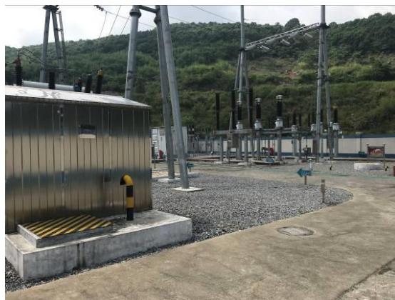
升压站配电装置区照片
